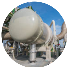
ZBIORNIKI CIŚNIENIOWE I KOTŁY
